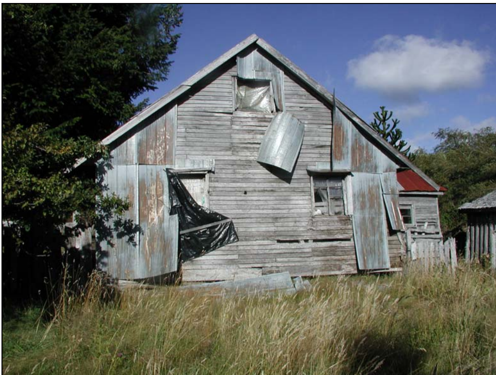
Fotografía 15. Parte trasera de la casa patronal en avanzado estado de deterioro
