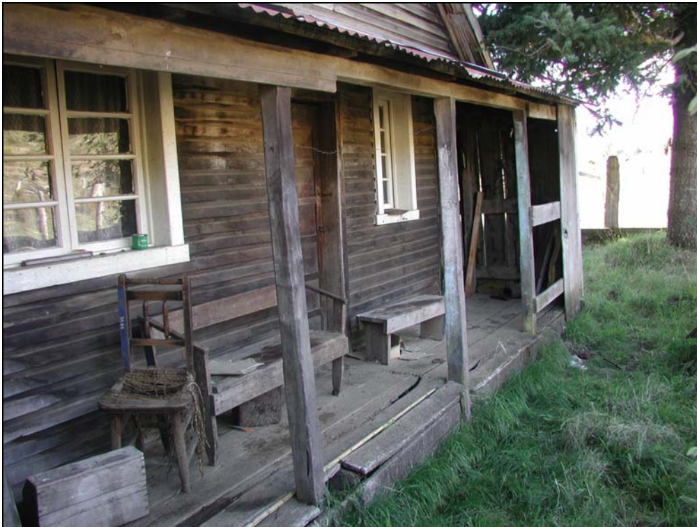
Fotografía 14. Parte delantera de la casa patronal en avanzado estado de deterioro
