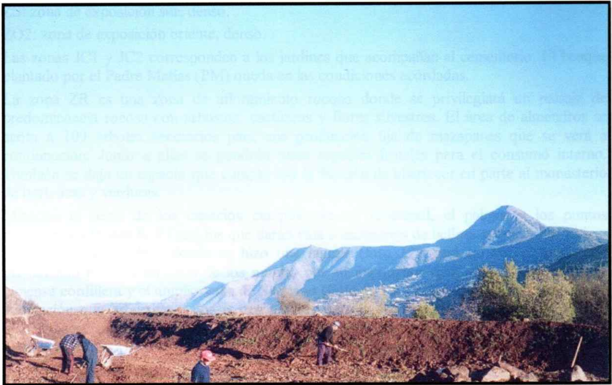
Foto 7. Laguna en construcción en el Jardín de la cumbre del cerro Los Piques (Foto: Francisco Larraín R.)
