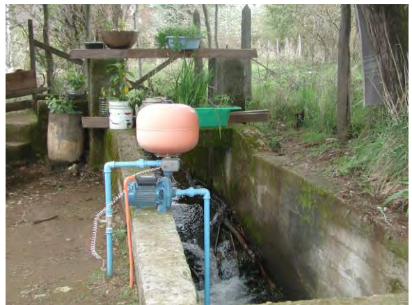
Bomba de agua, canal (hidroestructura)
